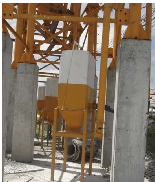
รูปเครื่องกรองฝุ่น ที่เกิดจากถังเก็บปูนซีเมนต์ผง
